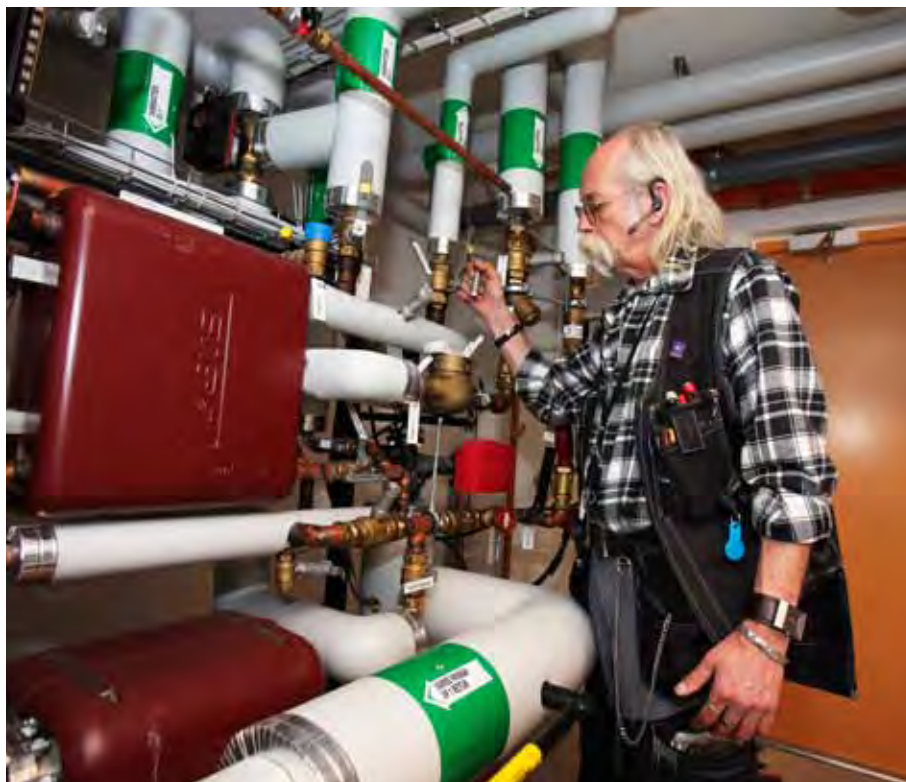
– Det finns stor besparingspotential genom optimeringar av uppvärmnings-, ventilations- och fläktsystemen i fastigheterna, konstaterar Stefan Ottosson, energitekniker på Sollentunahem.
